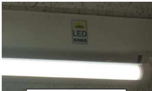
導入したLED照明
